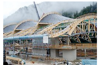
Le chantier du nouveau palais des glaces à Inzell (Photo: R. Meillard)
